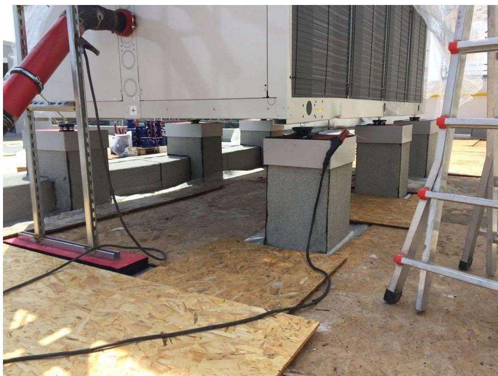
Impiantistica sollevata su baggioli, per permettere accesso a carponi dei manutentori
