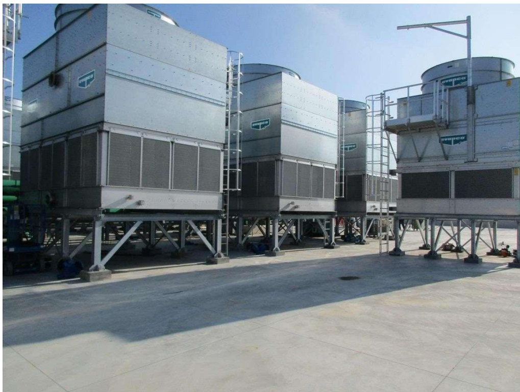
Impiantistica sollevata su baggioli e pilastri, per permettere accesso a carponi dei manutentori
