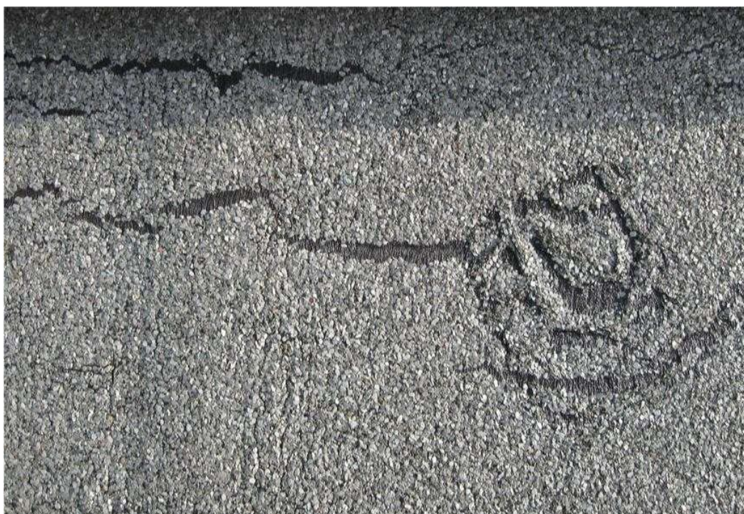
Degrado dell'elemento di tenuta in membrana in bitume polimero, con esposizione dell'armatura, in adiacenza a condotti d'impianti in metallo riflettente lucido (temperatura rilevata oltre 120 °C)
