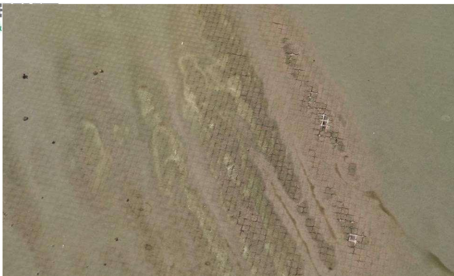
Degrado dell'elemento di tenuta in membrana sintetica, con esposizione dell'armatura, in adiacenza a condotti d'impianti in metallo riflettente lucido (temperatura rilevata oltre 120 °C)
