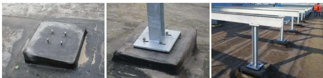
Impiantistica sollevata su baggioli e pilastri, per permettere accesso a carponi dei manutentori
