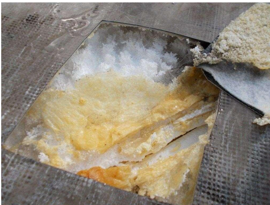
Fusione dello strato termoisolante in polistirene espanso sinterizzato, posto sotto l'elemento di tenuta, in adiacenza a condotti d'impianti in metallo riflettente lucido (temperatura rilevata oltre 120 °C)
